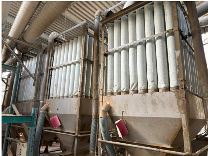
集塵機フィルターの交換 ( 集塵力アップ )
